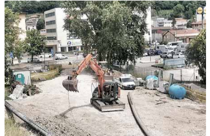
La ruspa ancora operativa ieri presso la fossa primaria di Campo Trentino
